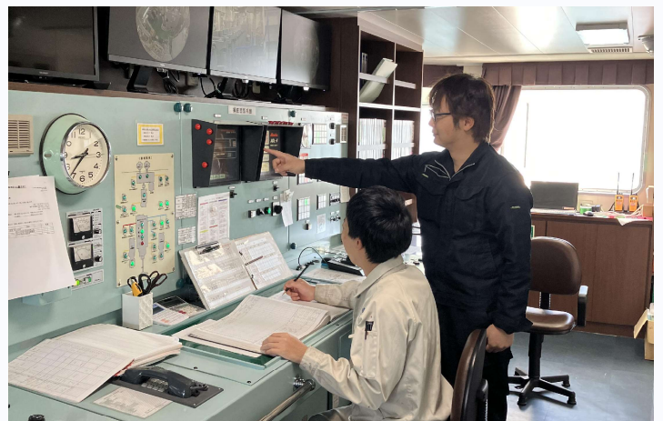
機関室遠隔制御システムおよび監視モニター
